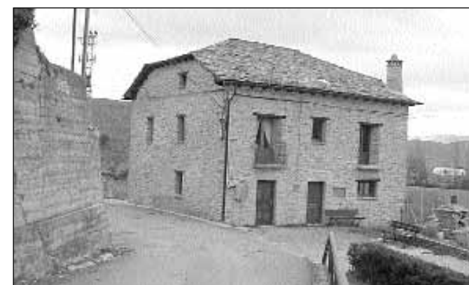
ARA Nueva carretera de entrada, obras de rehabilitación en el centro social, muro, nuevo parque infantil y alumbrado.
